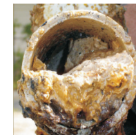
Taponamiento de tubería con grasas y aceites.
