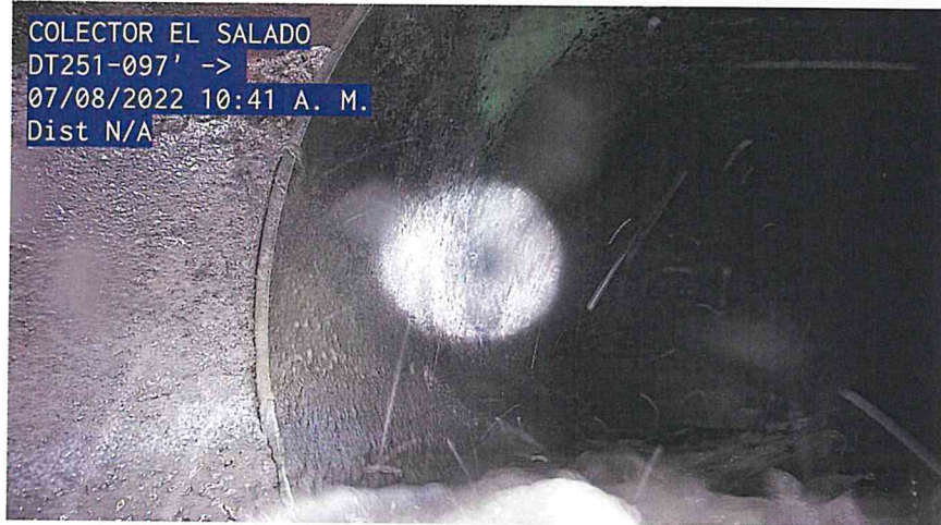
TUBERÍA DE PVC EN BUEN ESTADO
