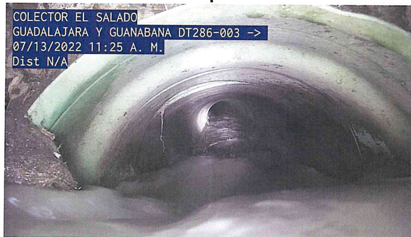
TUBERÍA DE PVC
