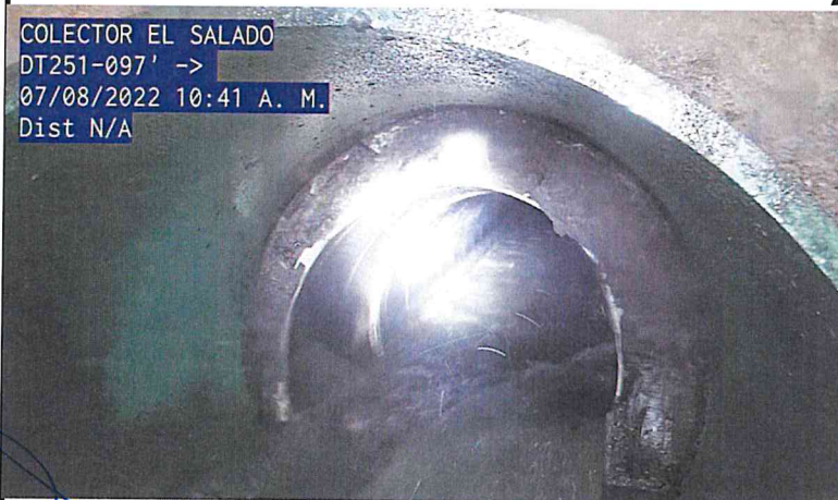
TUBERÍA DE PVC EN BUEN ESTADO
