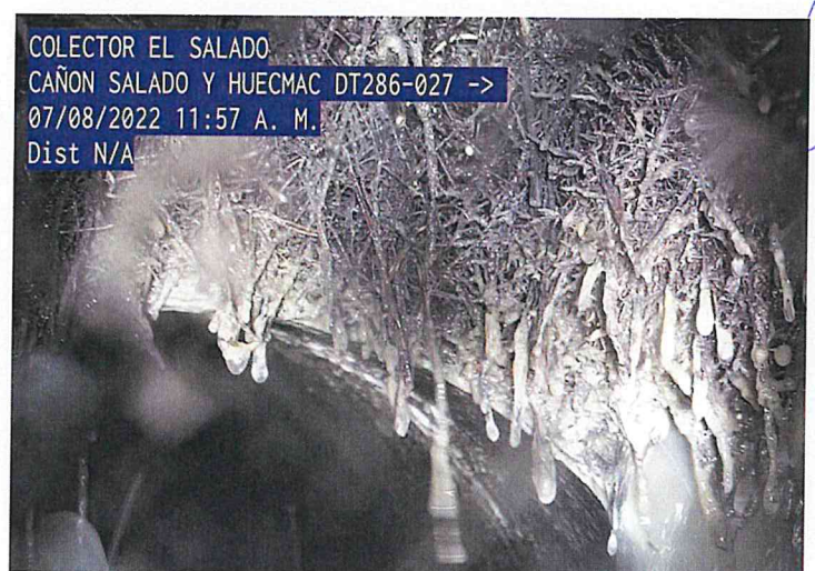
TUBERÍA DE PVC
