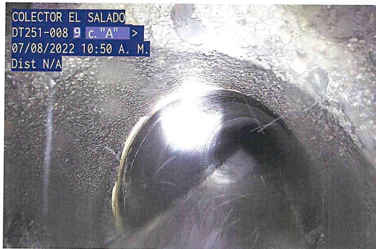
TUBERÍA DE PVC EN BUEN ESTADO
