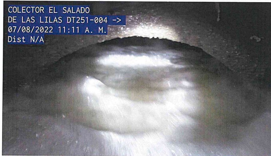
TUBERÍA DE CONCRETO CON DESGASTE
